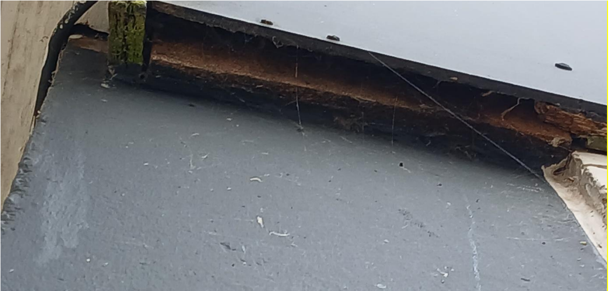
Abbildung 7: Einflugmöglichkeit über die Attikaverkleidung in das Dach des Gebäudes
